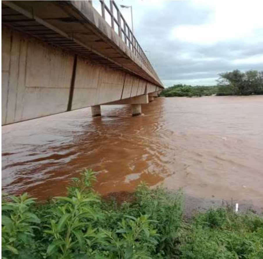
FIGURA 2: ENCHENTE PONTE DA INTEGRAÇÃO SÃO BORJA X SANTO TOMÉ (2023).
